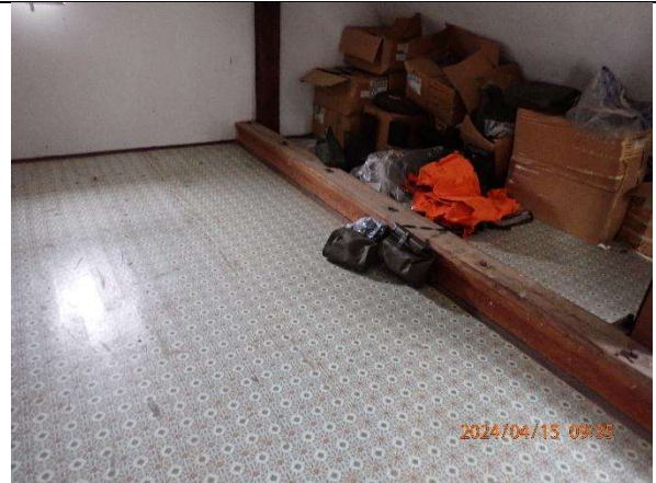
DG, West-/ Zentralbau, Boden, Belag MPA 1 24-15-00115-012 Chrysotil-Asbest nachgewiesen > 50 %
