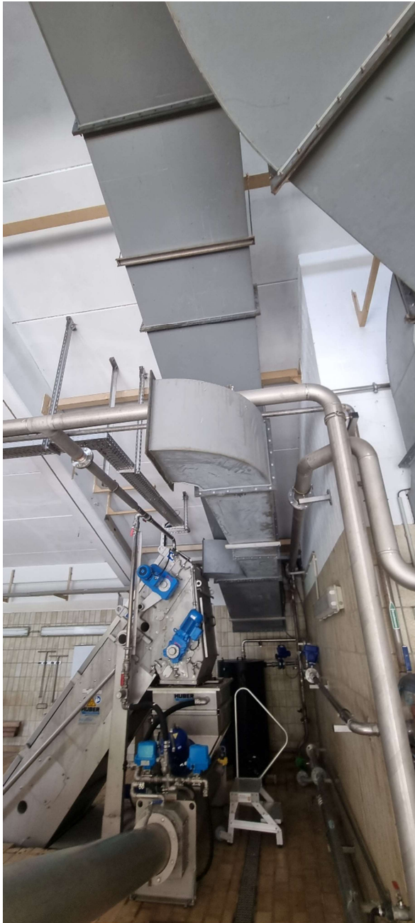
Abbildung 11: Abluftkanal 2 und 3 im Bereich der Rechen
