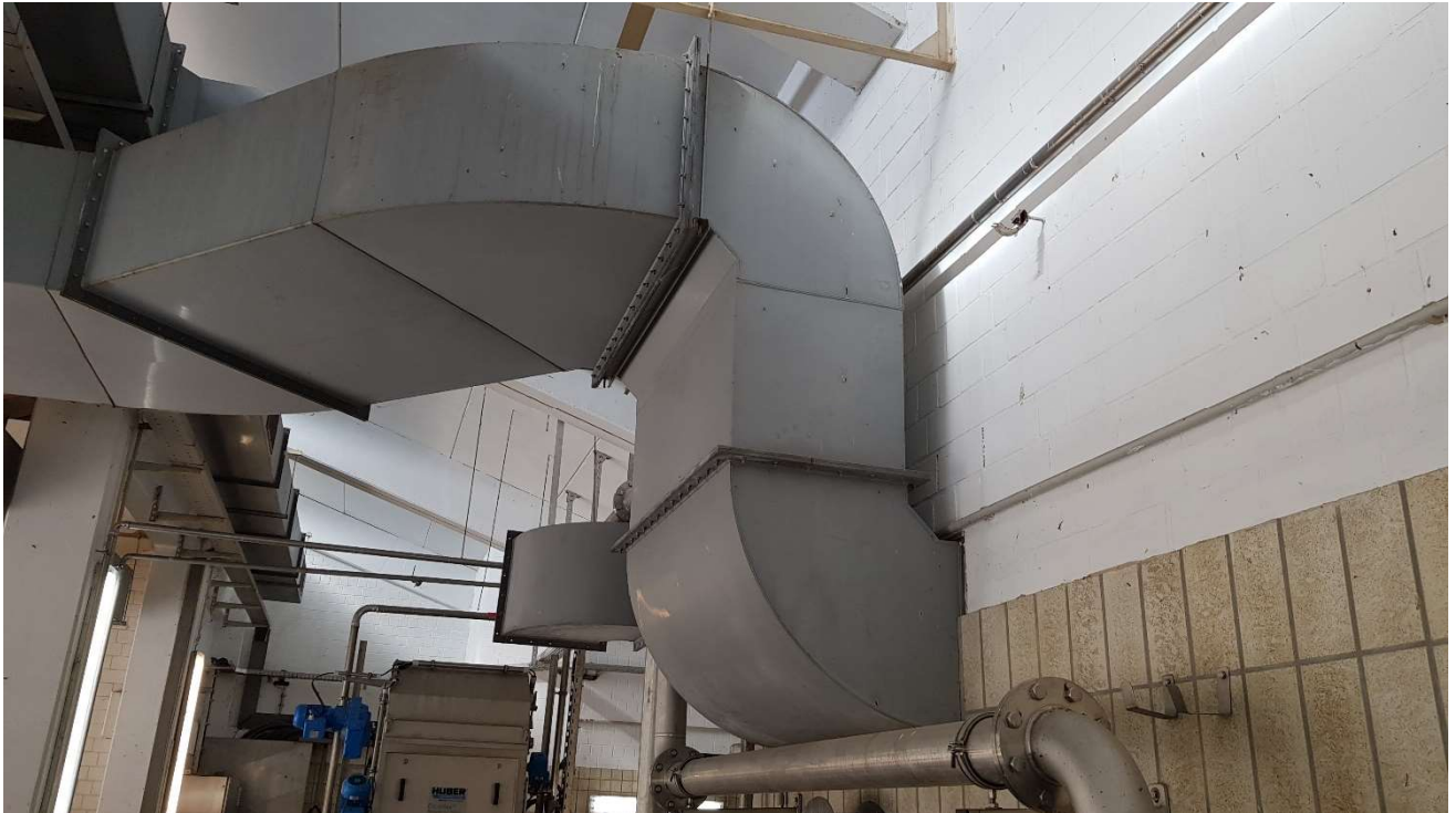
Abbildung 9: Rechenhalle, Zulufthauptkanal von der Klimabox
