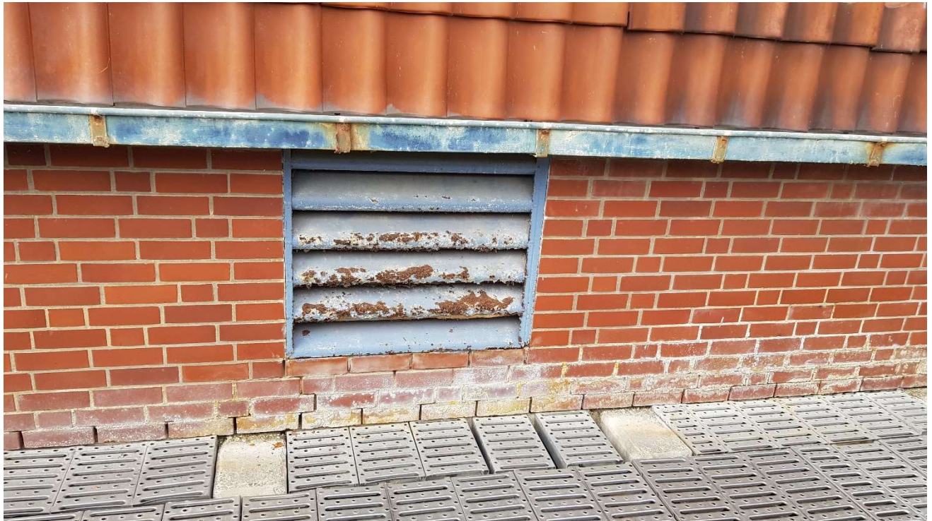
Abbildung 48: Rechenhalle, Zuluft Sandfanggebläse
