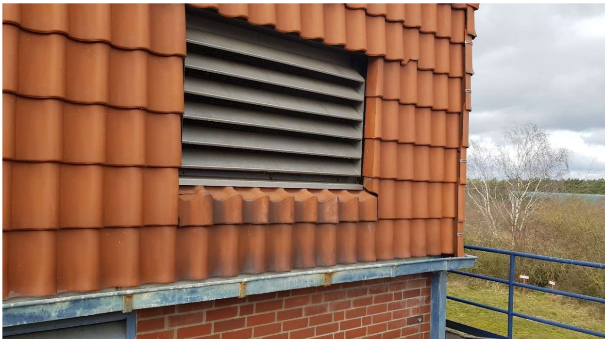
Abbildung 6: Rechenhalle, Zuluftjalousie Klimabox
