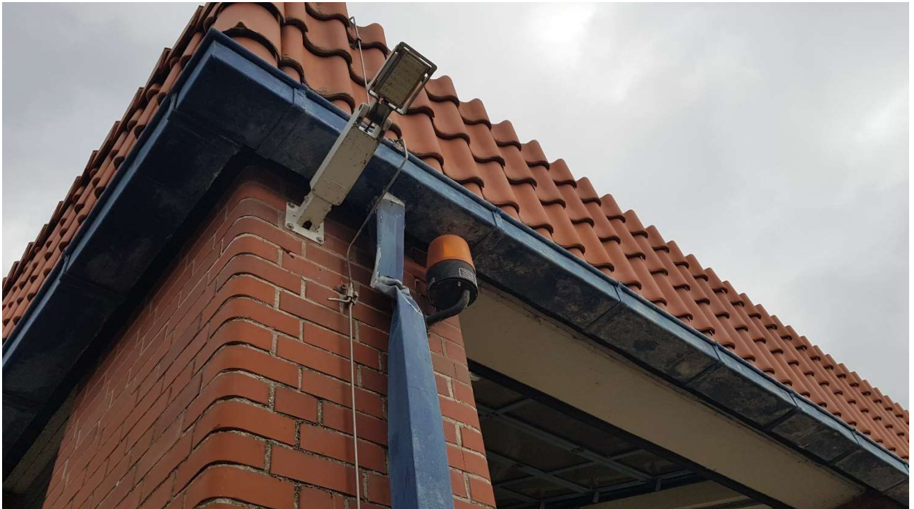
Abbildung 47: Defekte Regenrinne am Rechengebäude, Zustand Bestand
