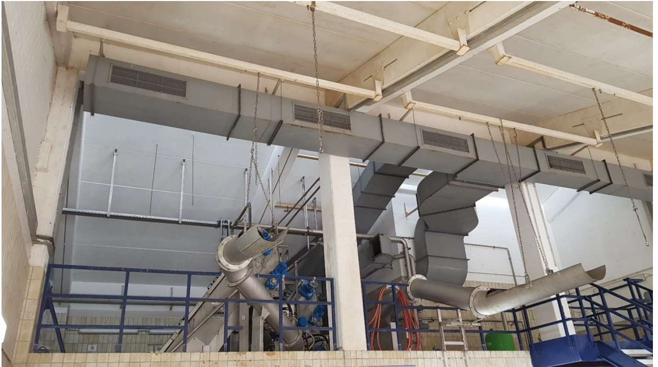
Abbildung 7: Rechenhalle, Frischluft/Warmluftkanal mit Lüftungsgitter
