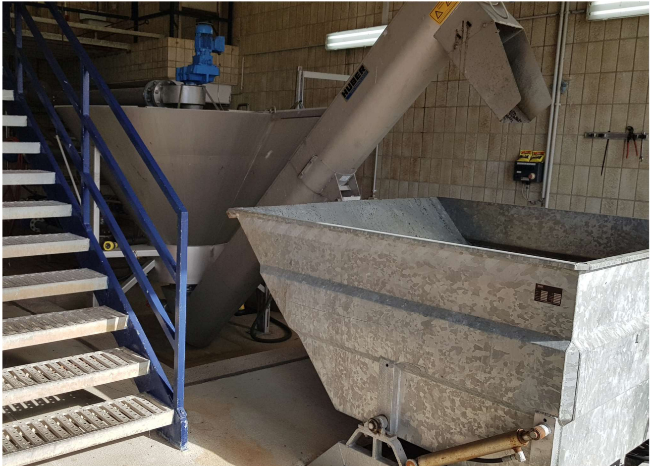
Abbildung 46: Sandwäscher mit provisorischer Waschwasserablaufleitung
