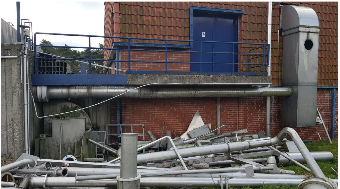
Abbildung 15: Biofilter Bestand, Abluftleitung vom Sandfang
