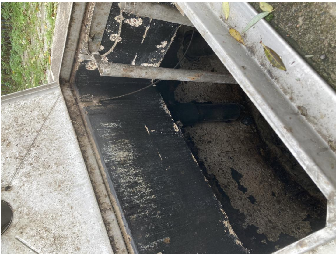
Schachtabdeckung und Führungsrohre
