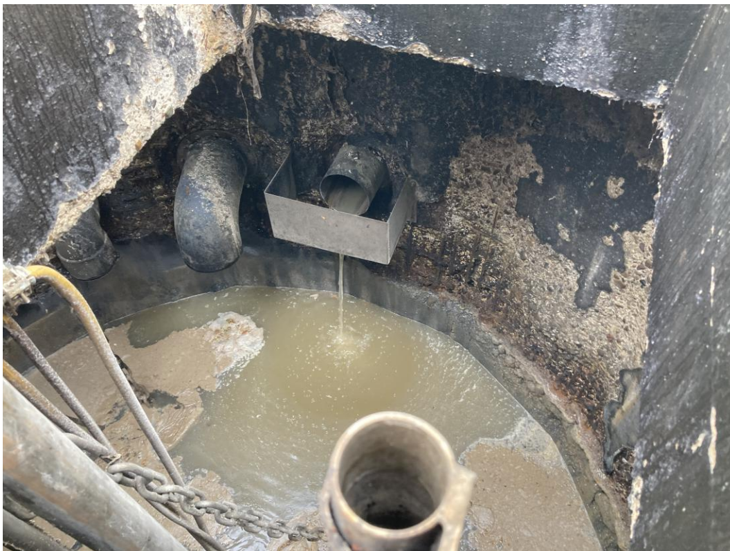
Einmündung Freigefällekanal mit Prallblech
