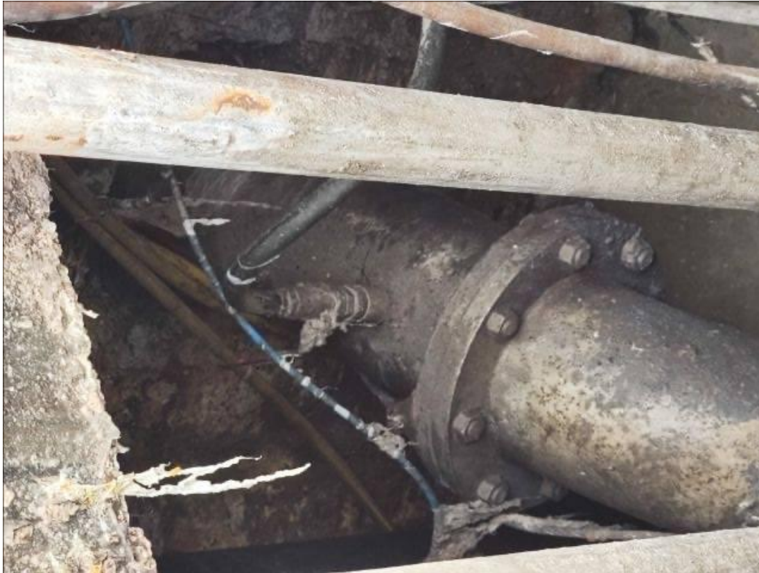
Verrohrung im Pumpwerk mit Druckluftanschluss
