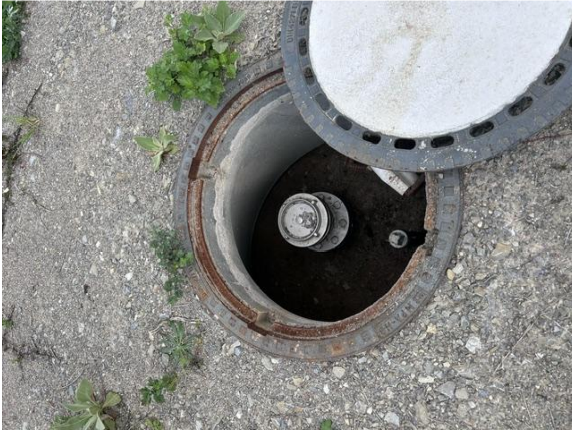
Anschluss Druckrohrleitung von Kleinsteimke
