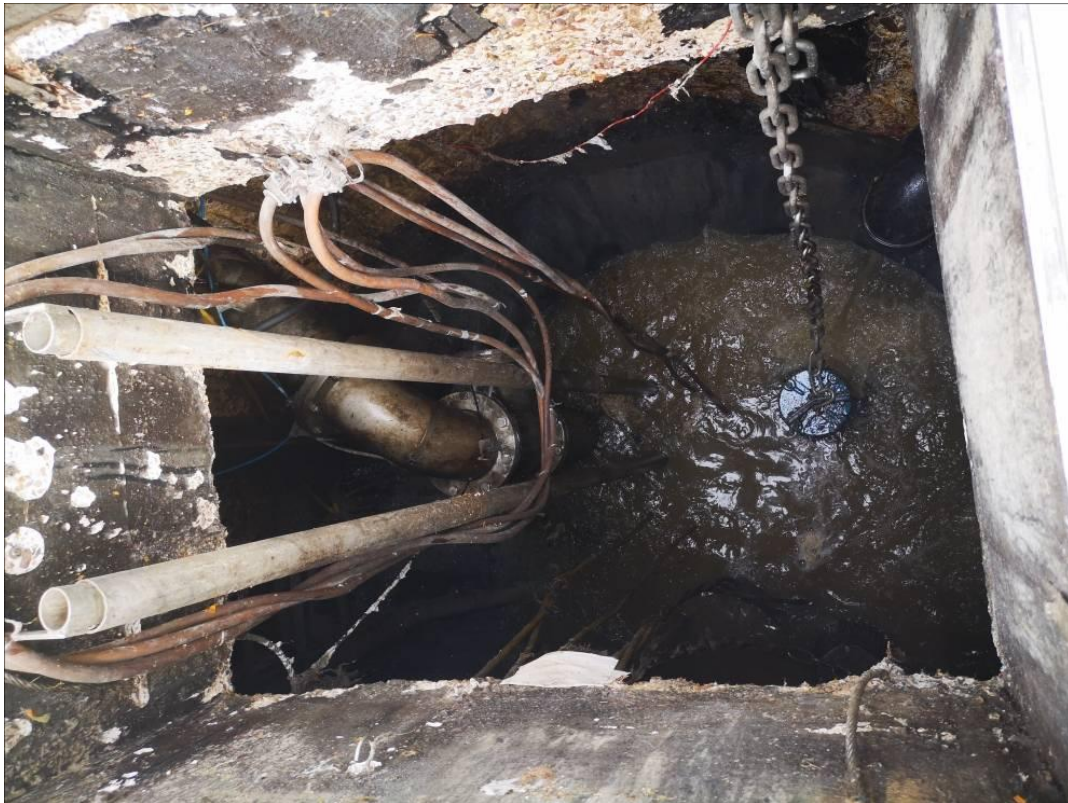
Pumpenschacht mit Führungsrohren
