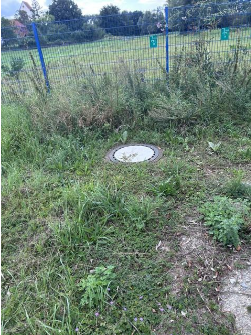
Schachtkonus mit Druckanschlussstutzen nach Beienrode
