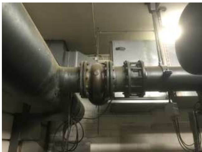
alte Druckleitungen mit Absperrschieber - zu demontieren
