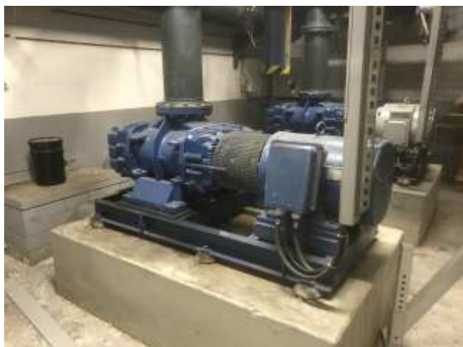
altes Gebläseaggregat Nr. 1 - zu demontieren
