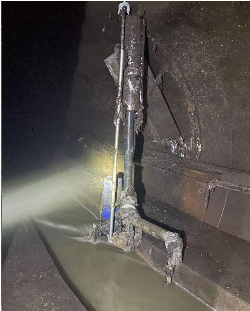
Wirbeljet mit Kabelpritsche und Steuerungskaste aus PE am Schacht 41299
