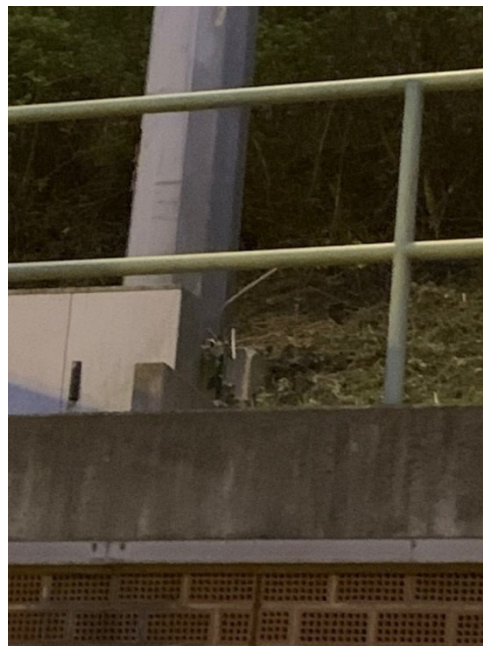
Abb. 16a: Schaltschrank LHM N2; Quelle: Foto HHVA
