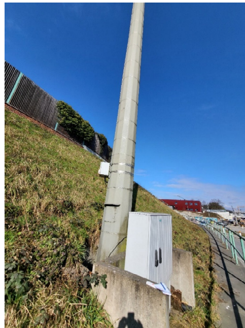
Abb. 18a: Schaltschrank LHM N4; Quelle: Foto HHVA
