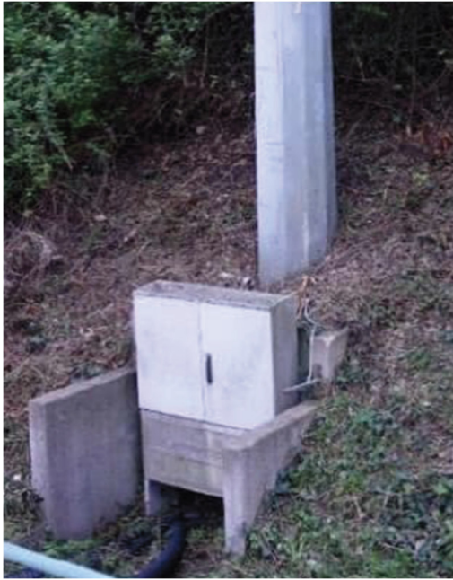
Abb. 16c: LHM N2 mit vorgelagertem Schaltschrank; Quelle: WTM 19.12.24
