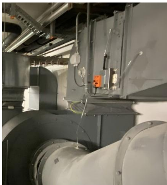
Abbildung 6 MSR-Bestand u. motorische Absperrklappe
